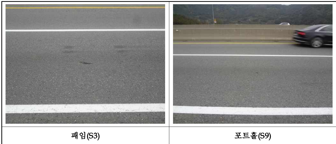
【사진 3.3.20】 교면포장 손상현황(부산,계속)
