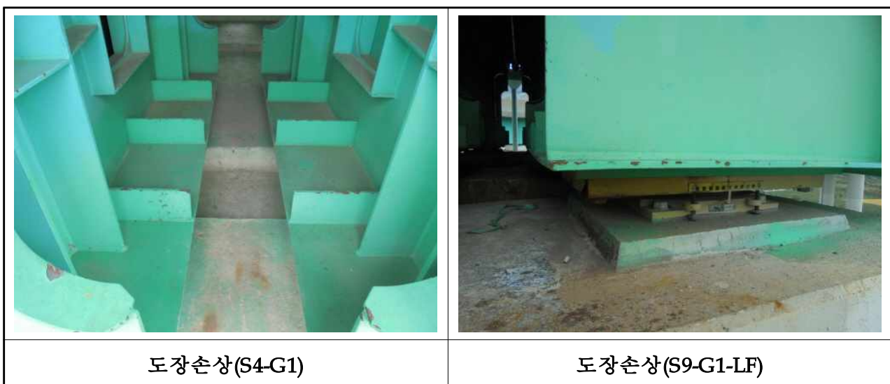
【사진 3.3.5】 강박스 거더 외부 손상현황(부산)
