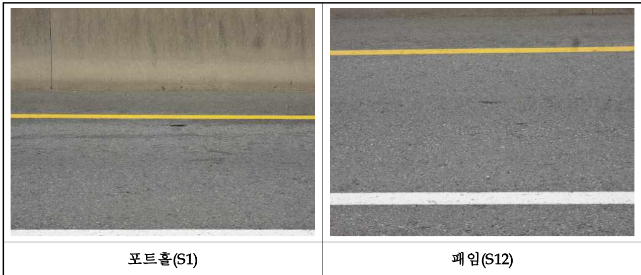
【사진 3.2.19】 교면포장 손상현황(대구,계속)
