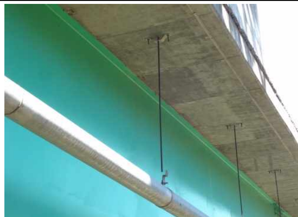
배수관 연결고리 탈락(S1)
