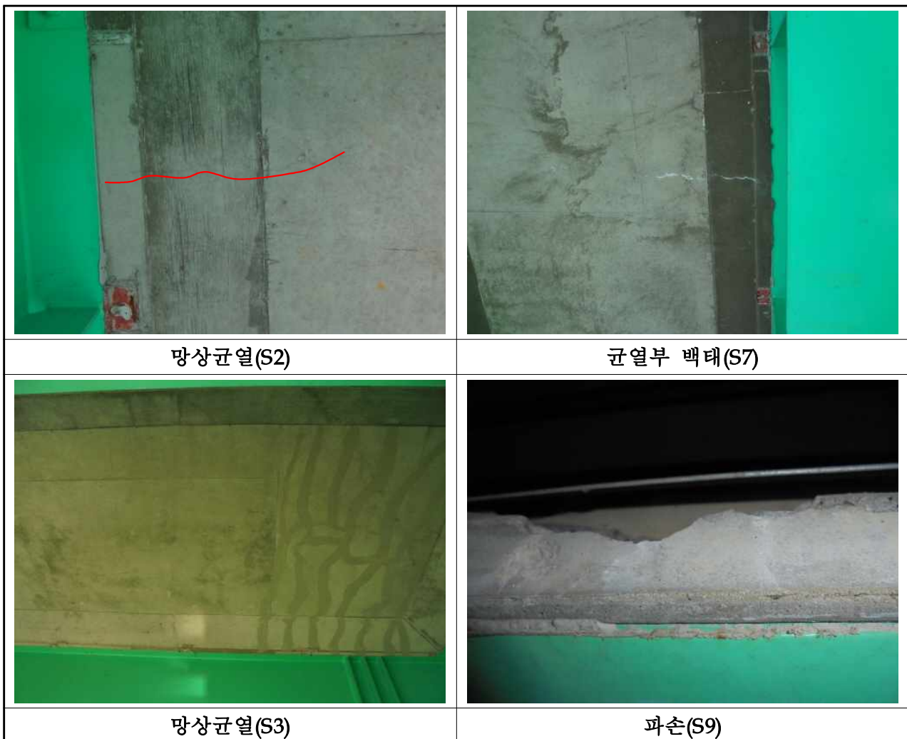
【사진 3.2.2】 바닥판 손상현황(대구)
