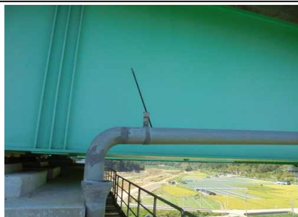
배수관 연결재 탈락(S6)
