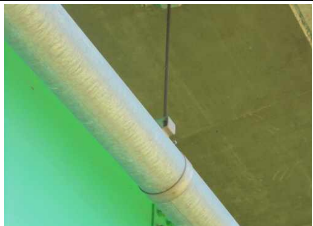
배수관 너트 탈락(S6)
