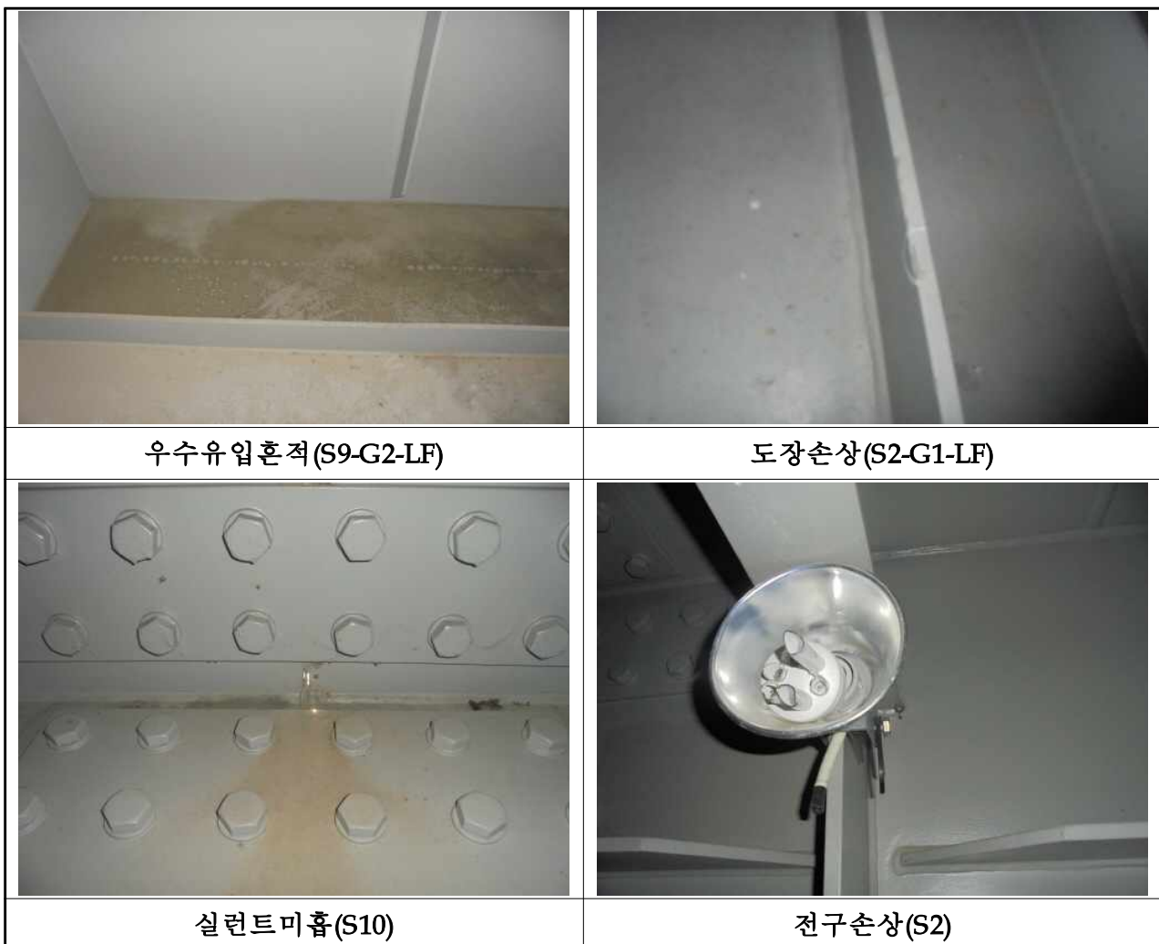
【사진 3.3.4】 강박스 거더 내부 손상현황(부산)
