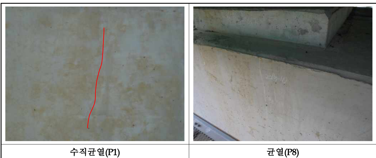
【사진 3.2.11】 교각 손상현황(대구)
