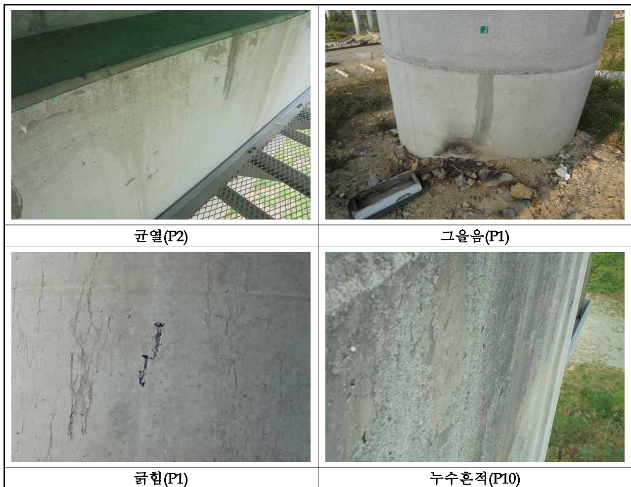
【사진 3.3.11】 교각 손상현황(부산)
