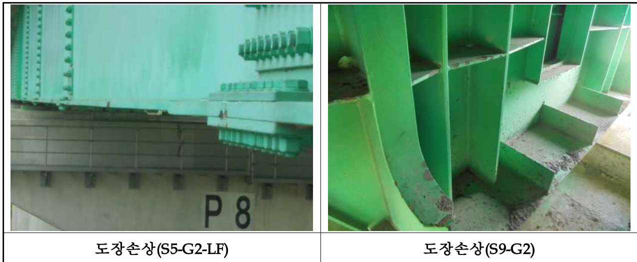
【사진 3.3.5】 강박스 거더 외부 손상현황(부산,계속)
