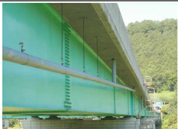
배수관 연결재 탈락(S6)
