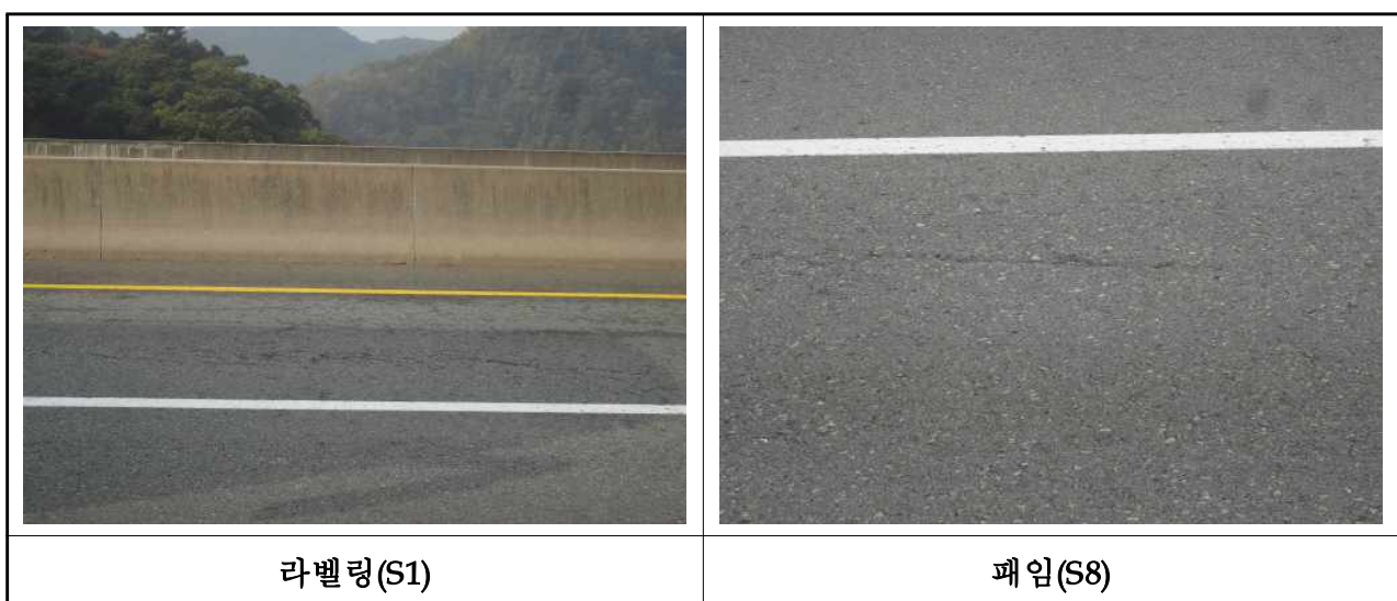
【사진 3.2.19】 교면포장 손상현황(대구)
